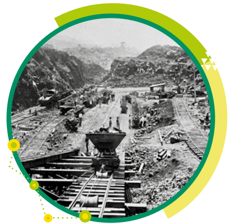
Obras para la construcción del Canal de Panamá, en 1907. Este canal permitió la comunicación entre el mar Caribe y el océano Pacífico.
